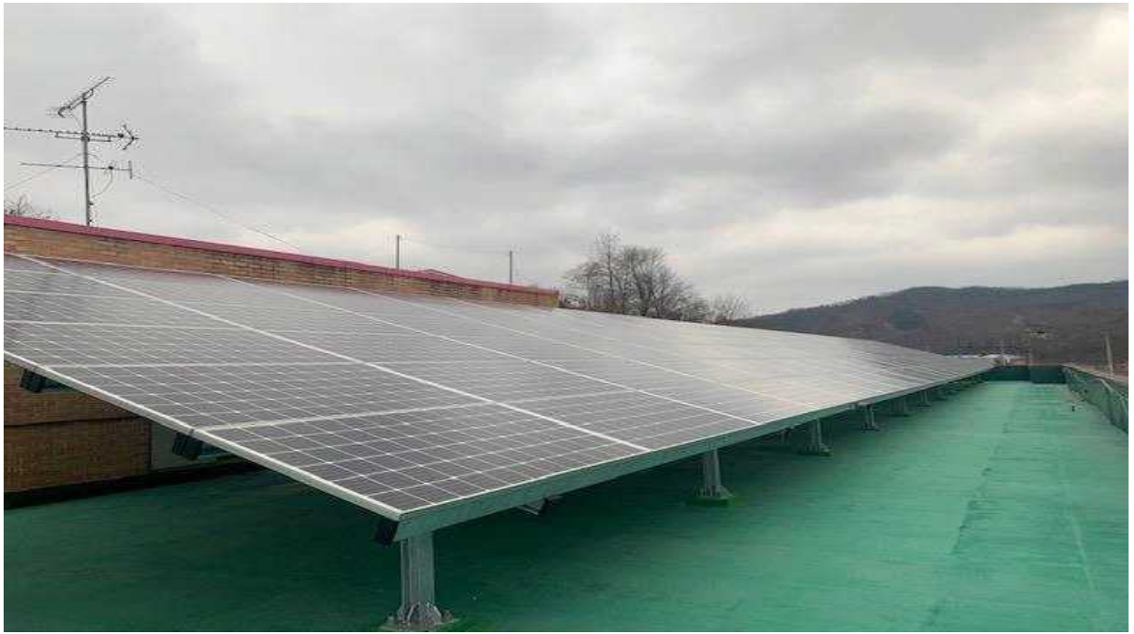
2020년 학교 태양광 발전시설 설치사업 완료(충주시 세성초등학교)
