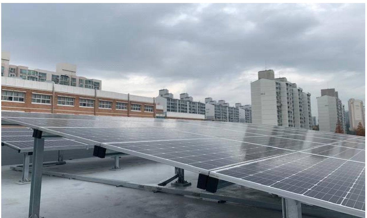
2020년 학교 태양광 발전시설 설치사업 완료(청주시 서원고등학교)
